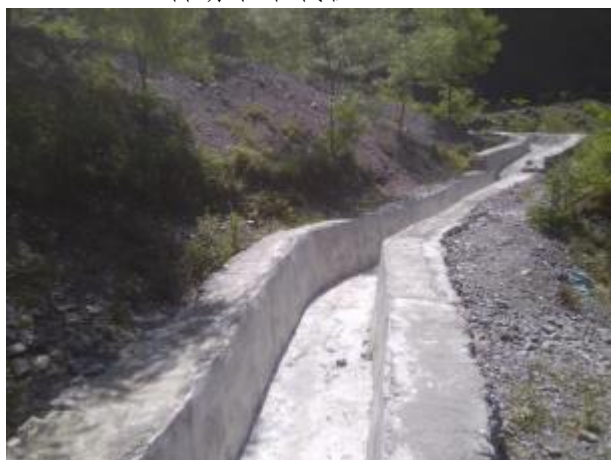
料场排水沟（一）
