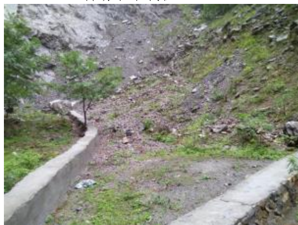
料场排水沟（二）
