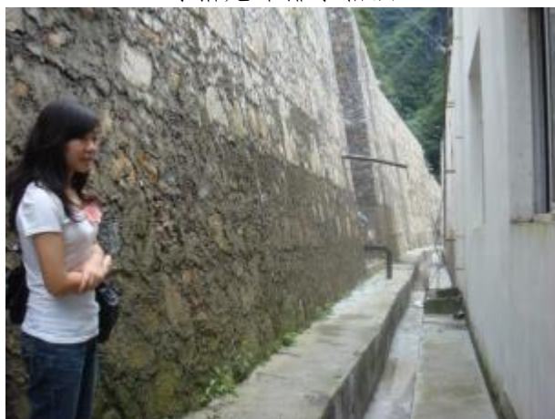
电站后排水沟
